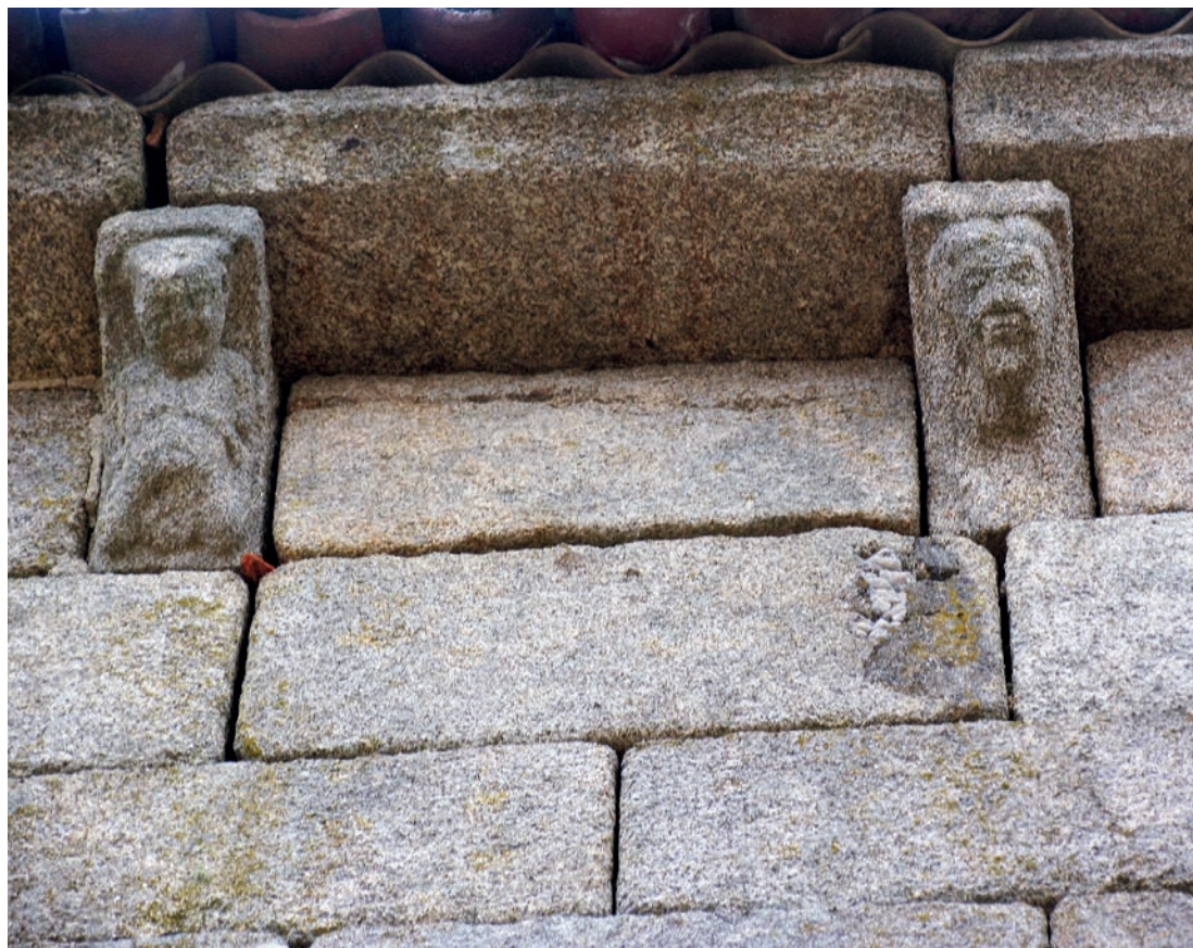
Canecillos del muro sur
