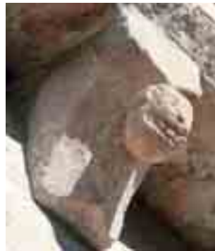
Muro sur. Canecillo 4
