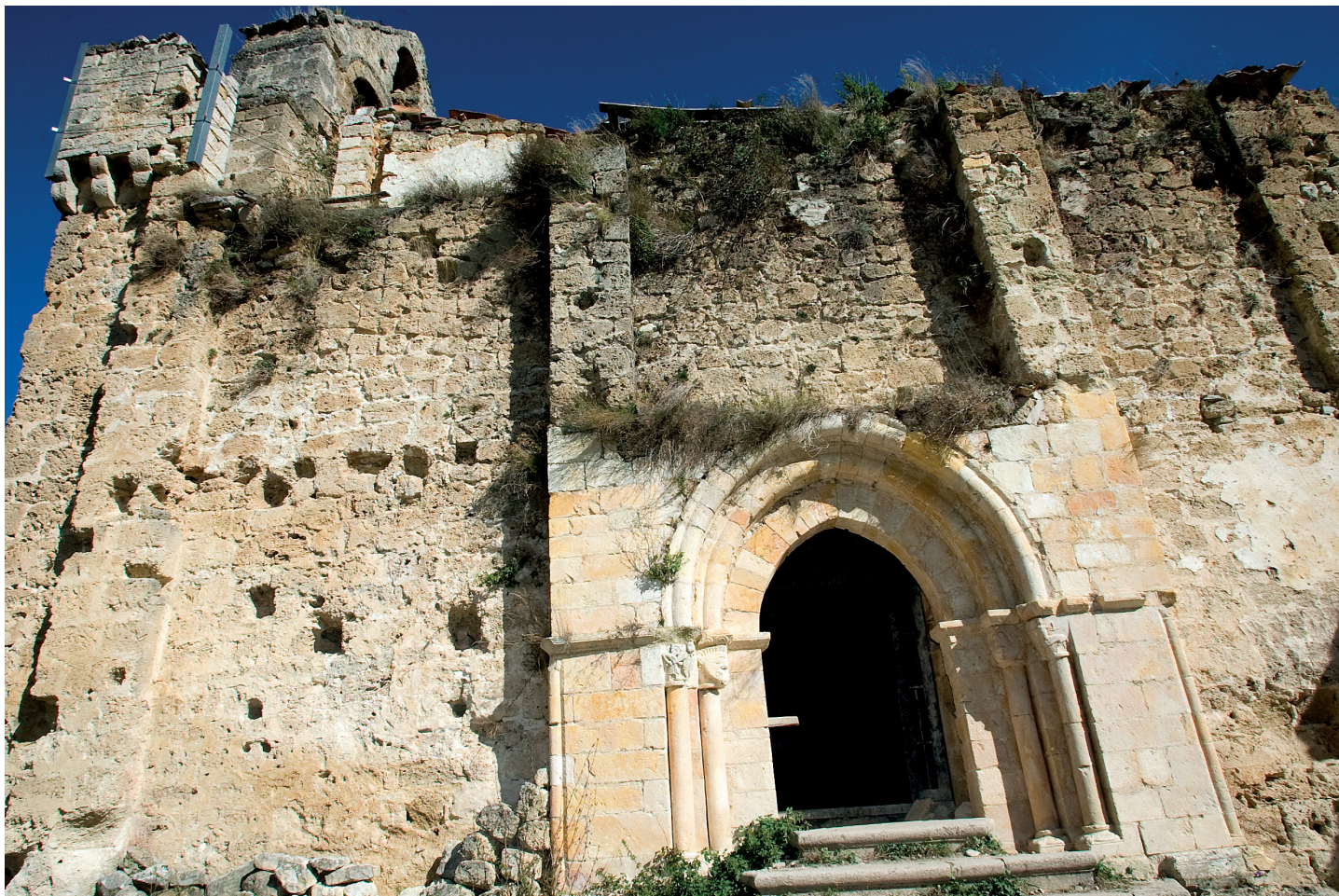
4. irudia. Riberako eliza, Gaubean, tokiko trabertinoekin eraikia, portada izan ezik, kareharri tertziarioekin eginda dago eta / Figura 4. Iglesia de Ribera de Valdegovía construida íntegramente con travertinos locales a excepción de la portada de calizas terciarias
