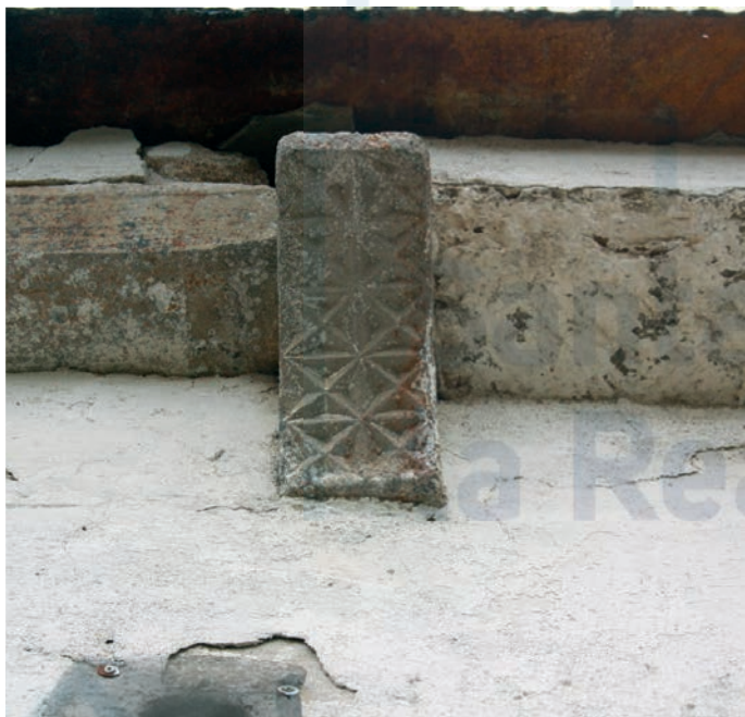
Canecillo del muro norte
