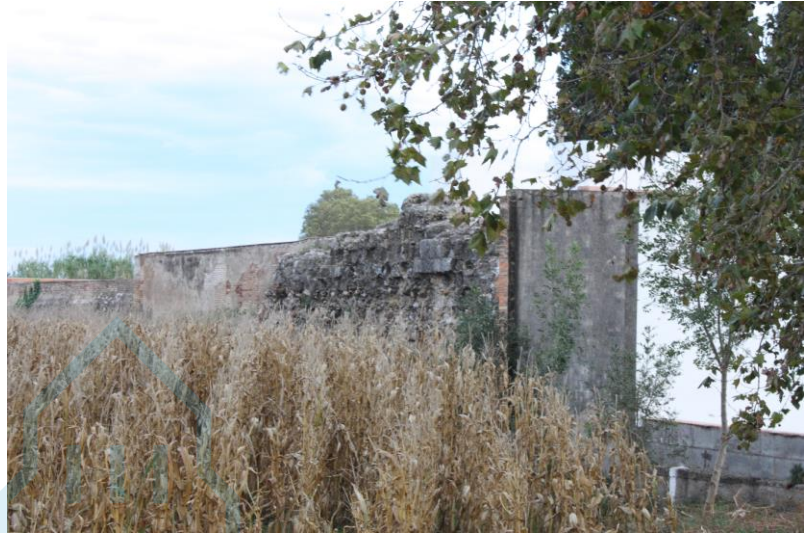
Restos de muro
