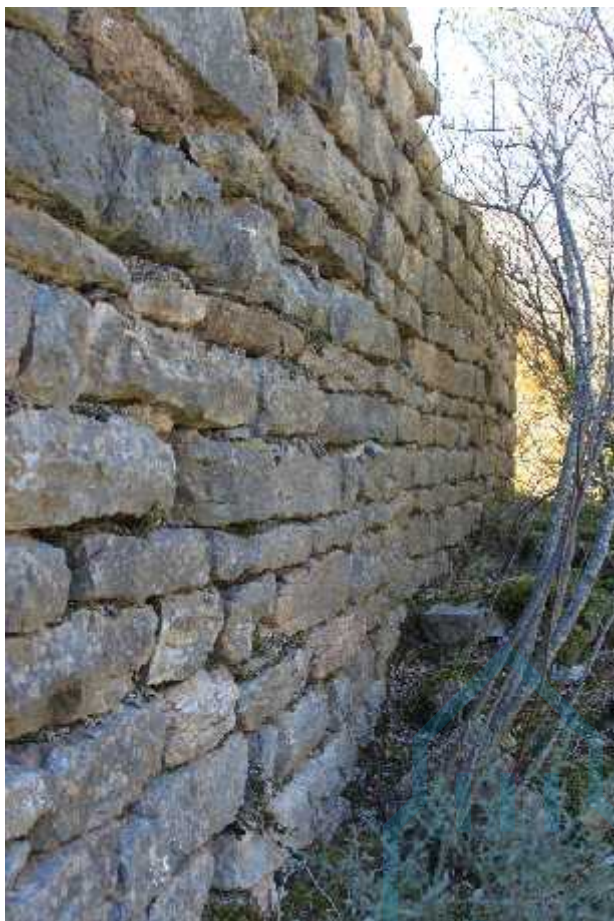
Restos del muro norte
